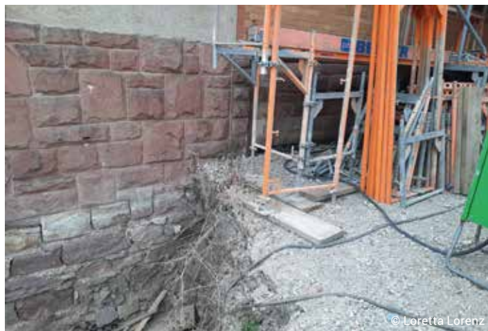
Tief geht es hinunter! Eine abendlich gänzlich unabgesicherte Baustelle in der Kronenstraße 21
